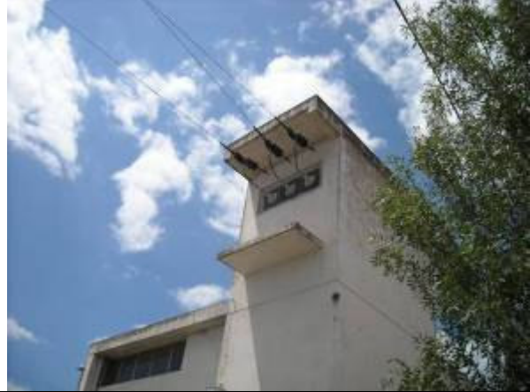
a) Isolamento de cabos na saída de um posto de transformação
