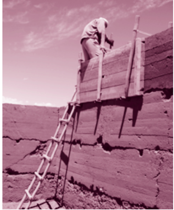
Realização actual de taipa, 2km a norte de Aït Bem Haddou, em Marrocos
